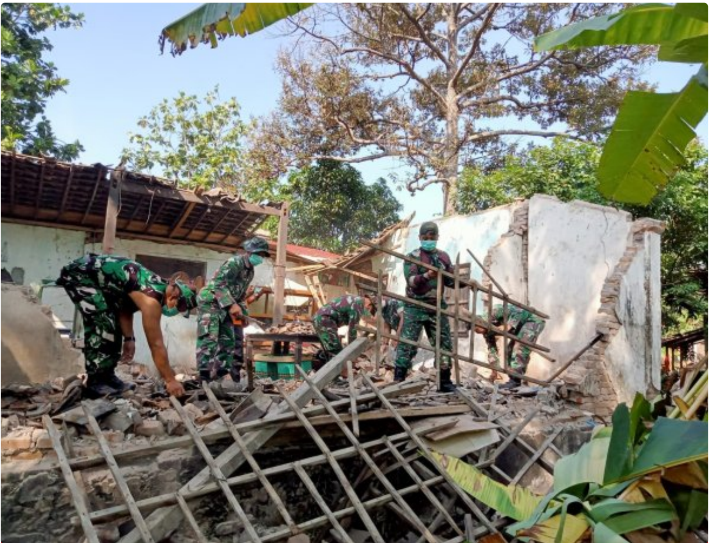
Koramil 05/Jatinom Turun Bantu Warga Terdampak Rumah Roboh Di Desa Krajan
